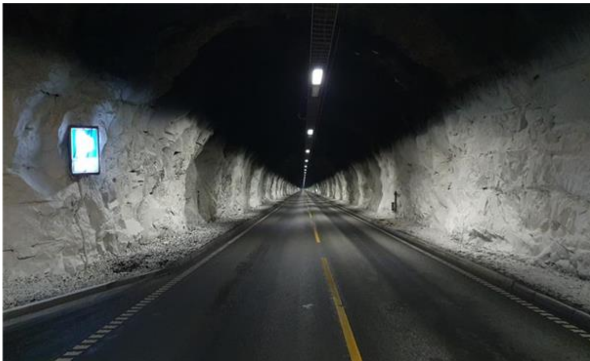
Fv. 108 Hvalertunnelen. Veggene i tunnelen ble i 2021 malt hvite for å bedre trafiksikkerheten. Fotograf: Hans Runar Kynningsrud, Viken fylkeskommune.
